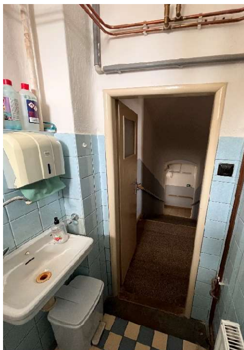
Původní stav WC 2. NP
