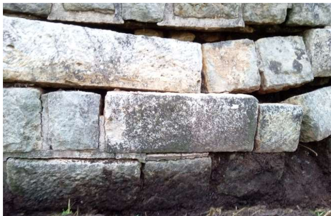
Stav nábrežní zídky před rekonstrukcí
