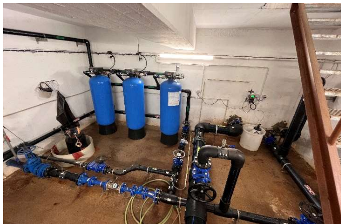
Nové technologické vybavení vodojemu v 1.PP
