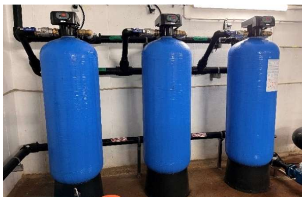
Odželezovací filtry v 1.PP
