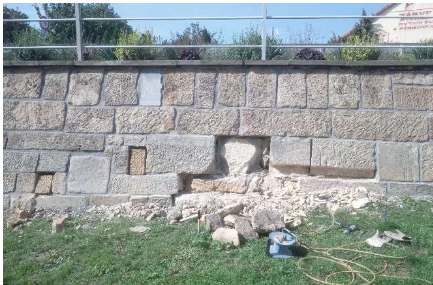
Uvolněné části zdiva před rekonstrukcí
