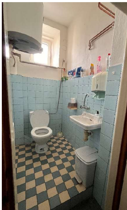
Původní stav WC 2. NP
